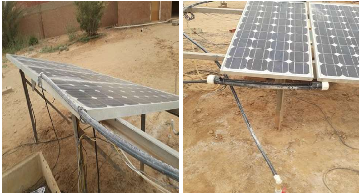
Figure IV.7: Photo du Circuit hydraulique de refroidissement
