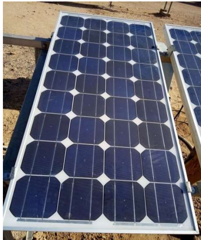
Figure IV.2 : Photos du panneau photovoltaïque de type « Isophoton I-75/12 »
