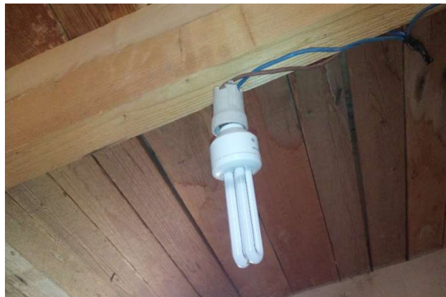
Figure IV.6: Photo de la lampe à courant continue
