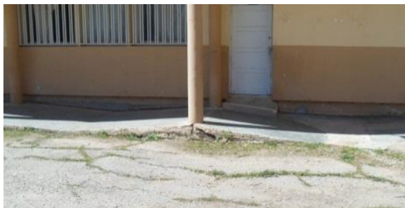
Figure I.11 : Déformation du dallage périphérique avec revêtement de chaussée fissuré
