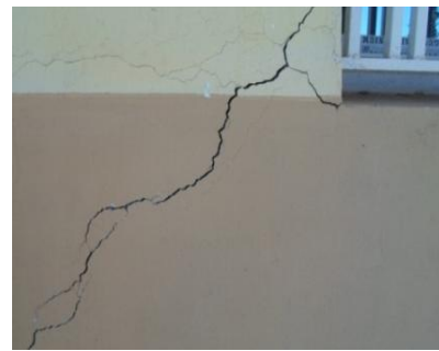
Figure I.10 : Fissure de forme oblique sur murs de façades
