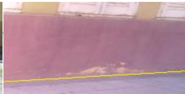
Figure I.12 : Affaissement du dallage périphérique
