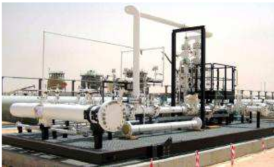
Fig. III.5 : Skid de comptage de gaz résiduel de Z-CINA
