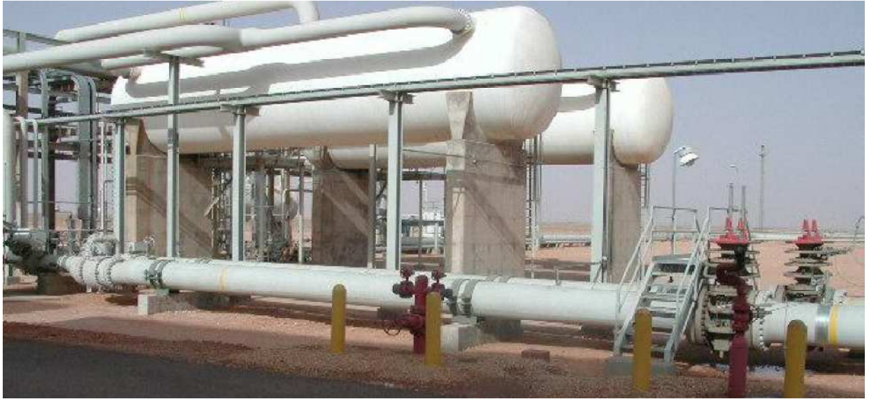
Fig. III.1 : Vue externe de l'unité de comptage de gaz du Groupement TFT/SH
