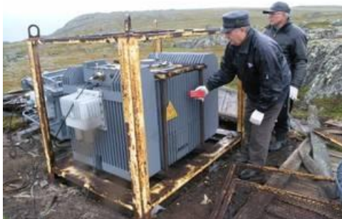
Figure I-8 : RTG utilisé pour alimenter les phares et les balises de navigation [73]
