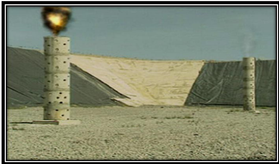
Figure I-6 .Photo de l'installation du biogaz
